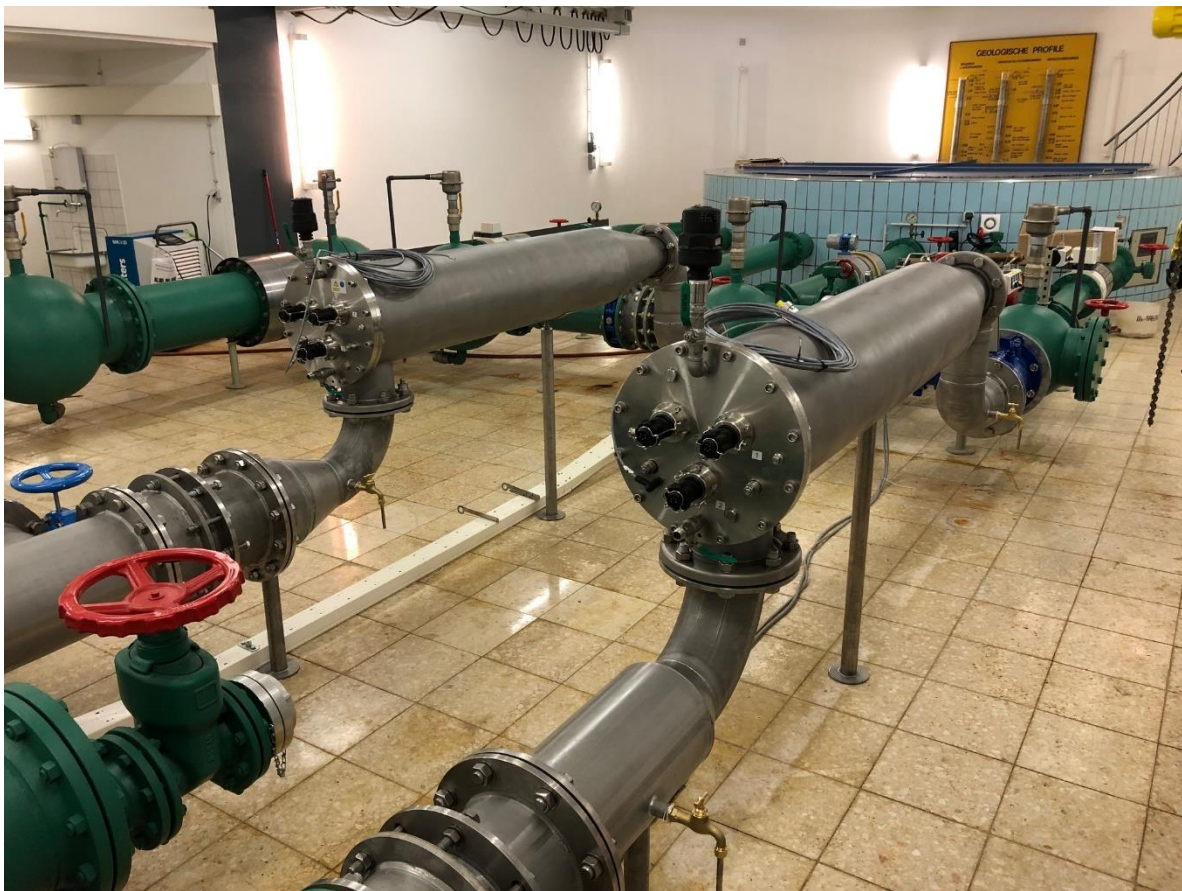
Foto: Grundwasserwerk Argendelta Langenargen („Obere Wiesen“) mit den neuen UV-Desinfektionsanlagen
